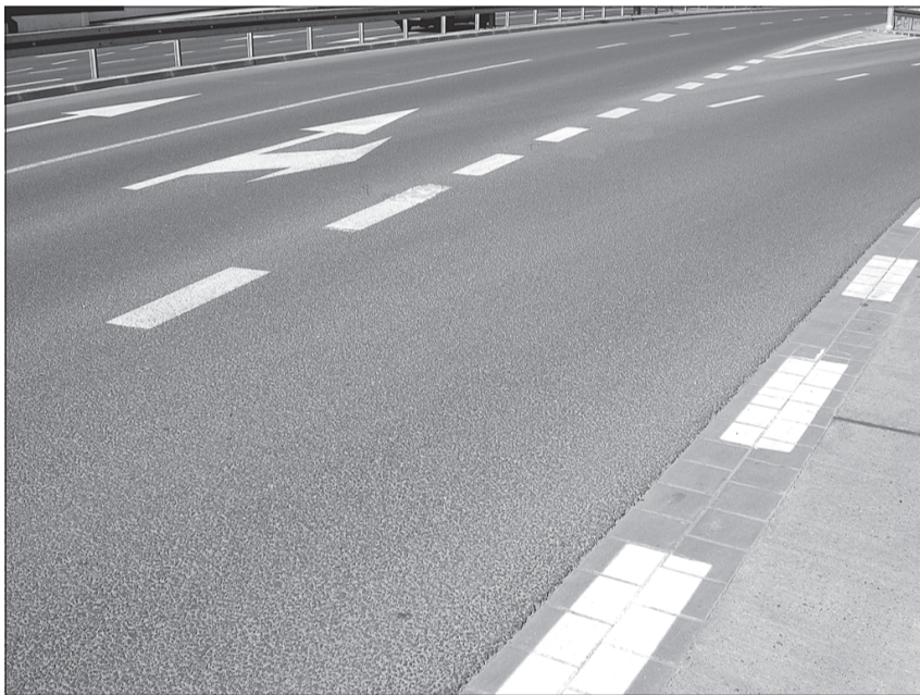
Wiadukt nad ulicą Wielicką został wykonany całkowicie z kruszyw wyprodukowanych w firmie Slag Recycling. Po kilku latach nawierzchnia wiaduktu jest w doskonałym stanie.
