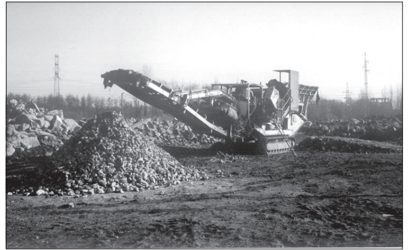
Spółka Madrohut, obok eksploatacji hałdy w Ruszcy, skupuje i przerabia gruz betonowy.
