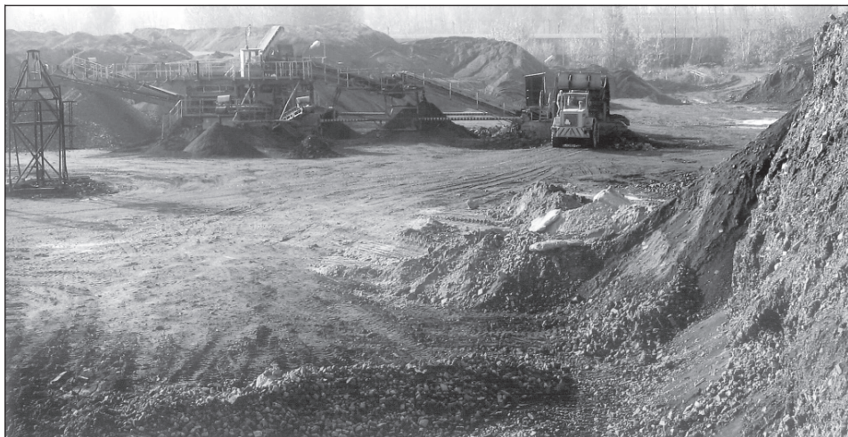
Słag Recycling niweluje hałdę w Pleszowie i na bieżąco przerabia żużle hutnicze...
